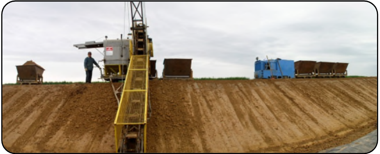
Vue du front de taille avec l'utilisation de l'excavateur et du loco-tracteur
